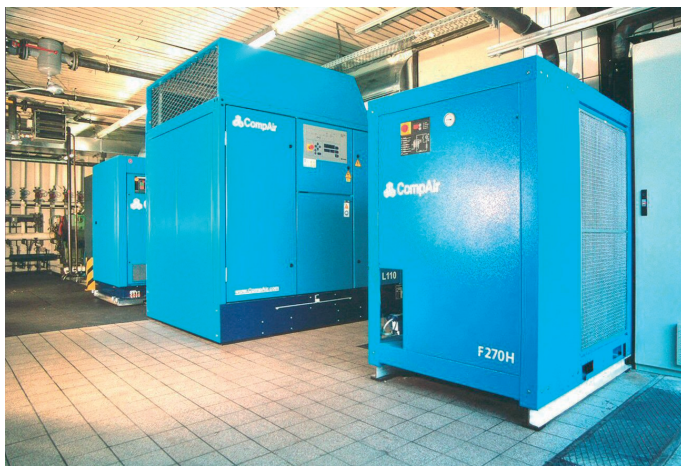
Druckluftstation der Oechsler AG in Ansbach
